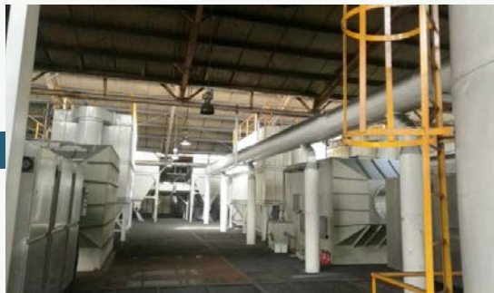
廢氣處理設備
