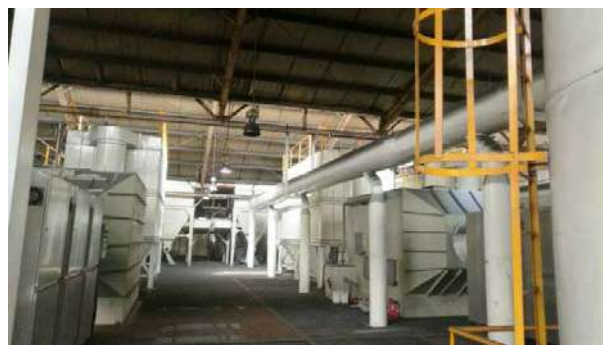
▲ 廢氣處理設備
