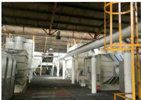
☞ 廢氣處理設備
